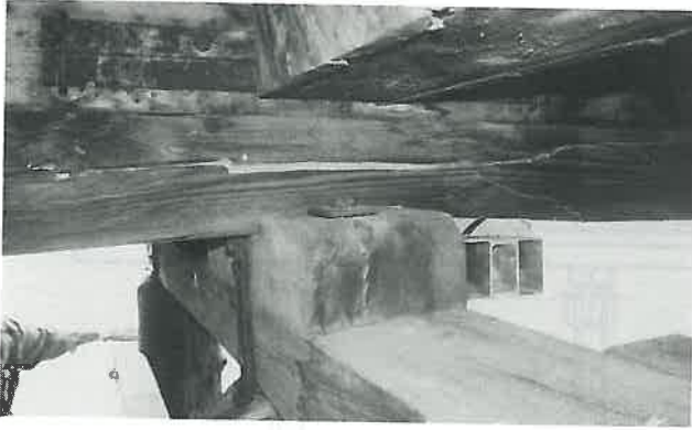
Abb. 48: Verdeckte Faulstellen in einem Sattelholz werden beim Test sichtbar
