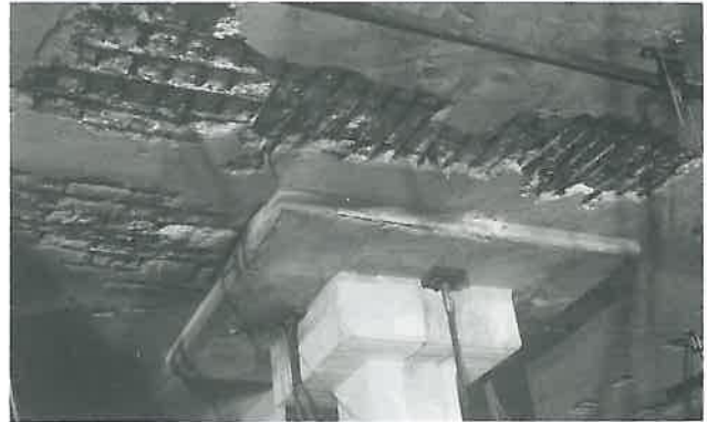
Abb. 25: Rückverankerung der diagonal angeordneten Rahmen gegen die Pilzköpfe. Die Korrosionsschäden wurden nach dem Test durch Sandstrahlen und Torkretieren beseitigt.
