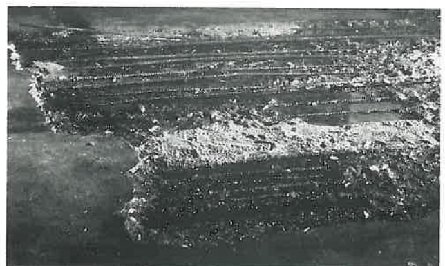
Abb. 32: Schalenförmige Betonabplatzungen durch stark korrodierte Stützbewehrung
