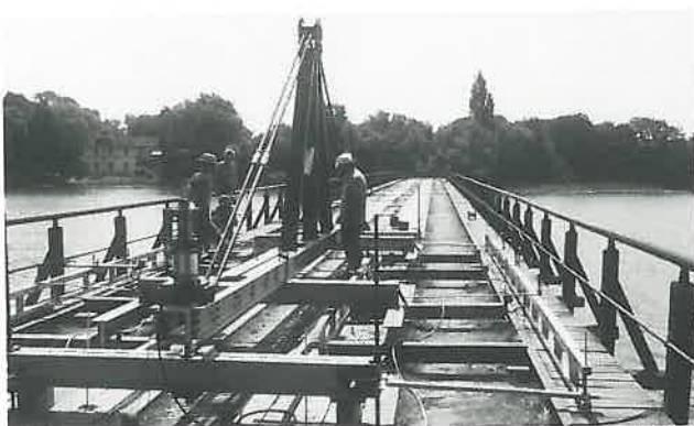
Abb. 45: Verfahrbare Testlasteinrichtung für max extF = 350 kN je Feld
