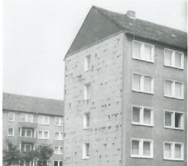
Abb. 10: Ablösen der Beschichtung einer äußeren Schaumglaswärmedämmung
