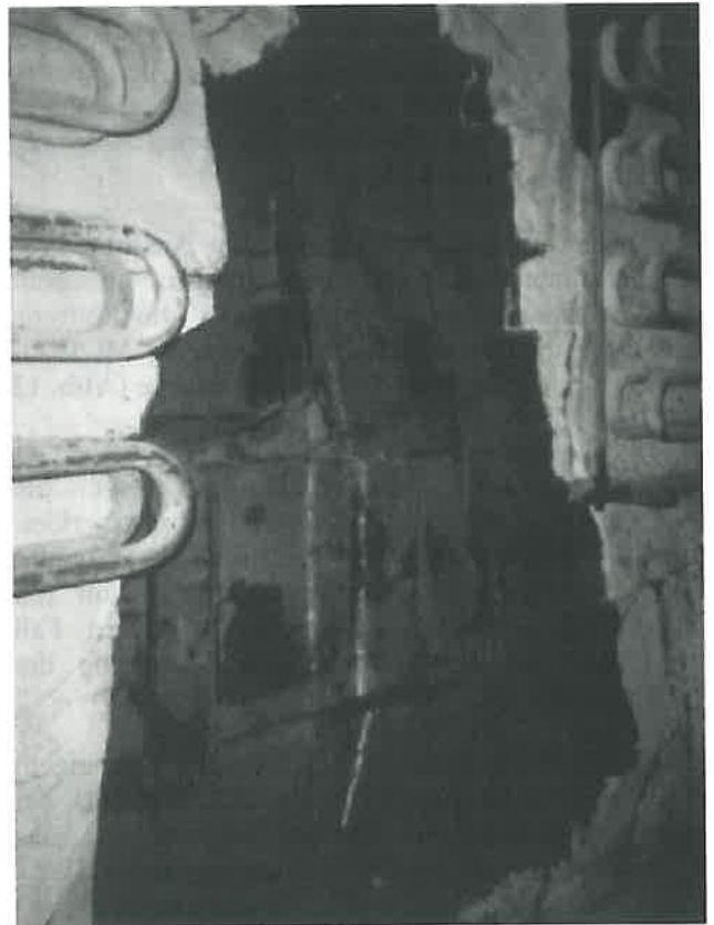
Abb. 15: Zerstörung einer Großkühlhallenwand infolge Unterfrierung
