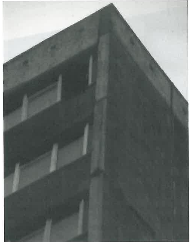
Abb. 14: Zerstörung von Leichtbeton-Außenwandplatten
