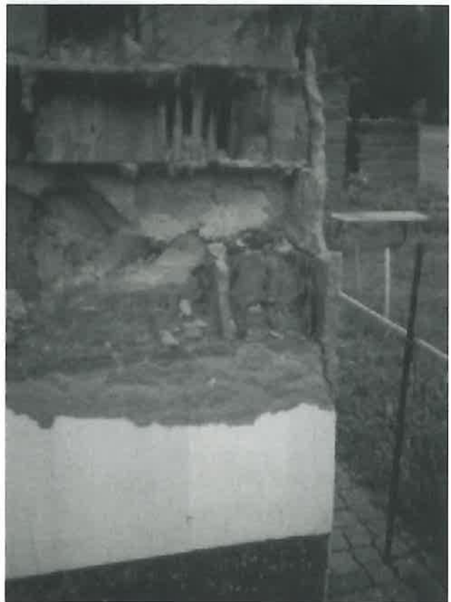
Abb 17: Zerfrierung einer Außenwand eines Eigenheims
