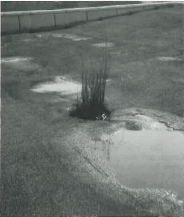
Abb. 24: Pflanzenwuchs und totale Zerstörung eines Warmdaches mit organischen Wärmedämmplatten
