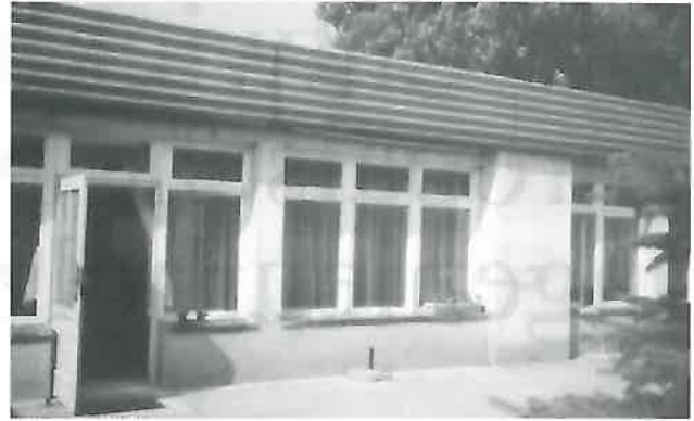
Abb. 25: Blende am Metaldach eines Bungalows
