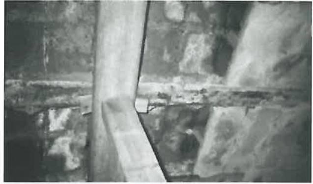
Abb. 16: Zerstörung einer F-Balken-Decke in einem Einfamilienhaus durch ein ungeeignetes Warmdach mit unklassifizierter Schlacke als Wärmedämmung
