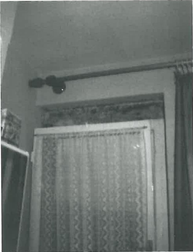
Abb. 12: Schimmelbildung an Wärmebrücke
