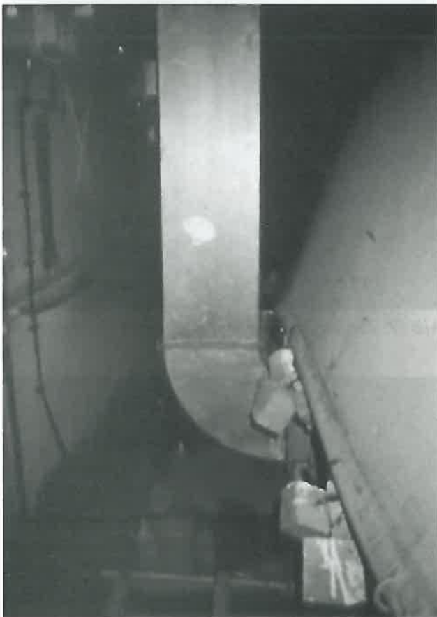
Abb. 20: Tauwasseranfall im Gebäudeinnern
