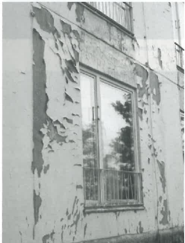
Abb. 11: Abplatzungen von Latexanstrichen auf Außenwandplatte
