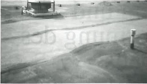
Abb. 23: Zerstörung von organischen Wärmedämmplatten eines Warmdaches infolge Feuchtigkeit
