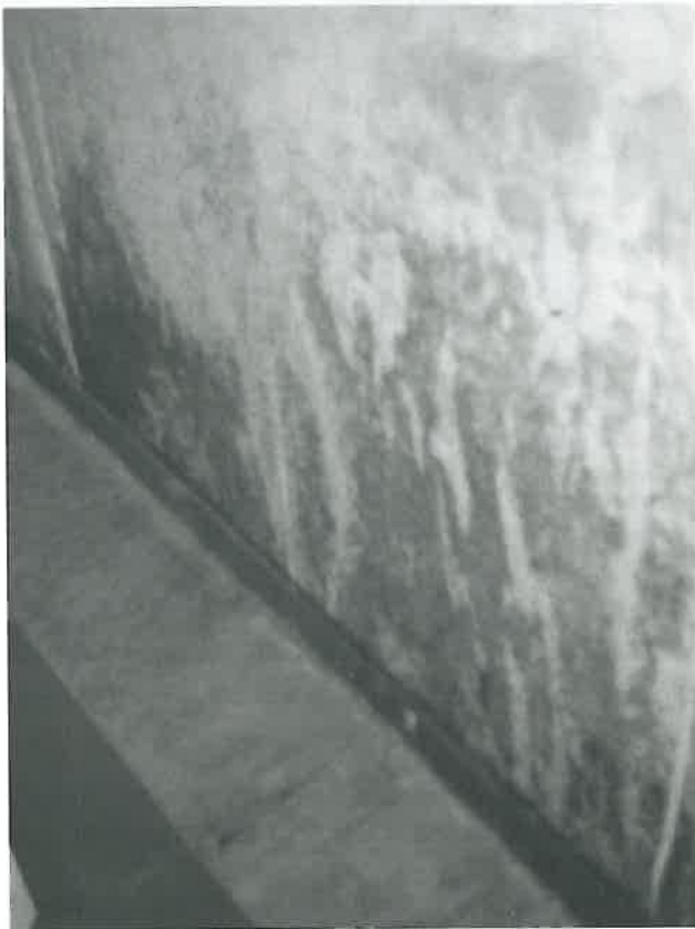
Abb. 13: Schimmelbildung hinter einen geschlossenen Schrankwand
