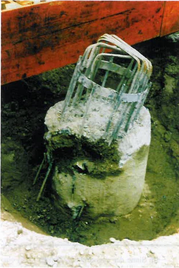
Mangelnde Sorgfalt beim Einbau von Pfahlanschlußbewehrung
