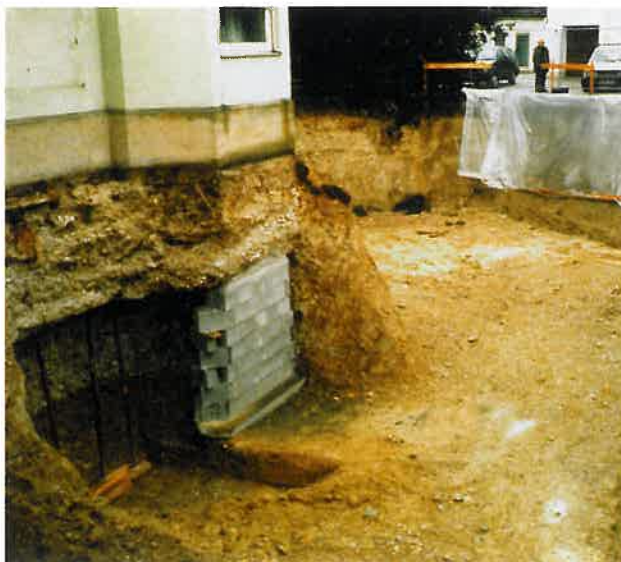
Gefährliche Improvisation bei einer Gebäudeunterfangung
