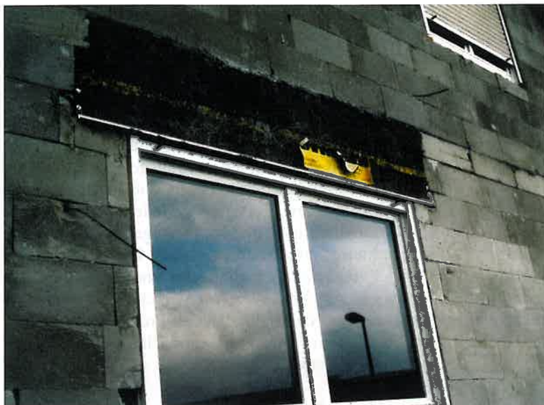
Rolladenkasten länger als Fenstersturz! Wo bleibt die Auflagerkraft?
