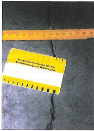
Abb. 5: Detailaufnahmen einzelner Risse in der Bodenplatte
