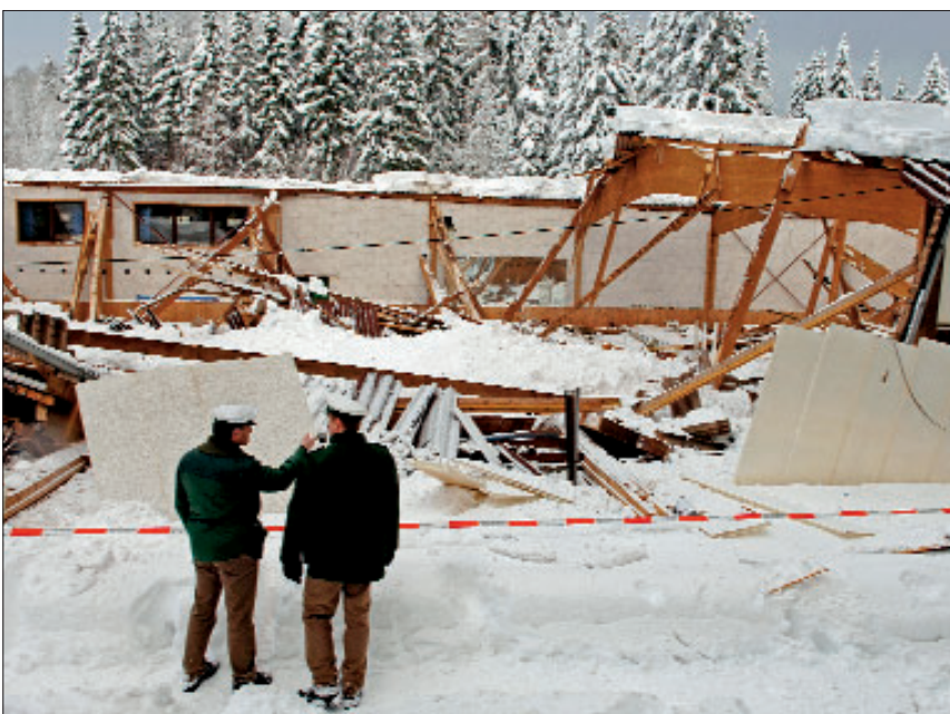
Abb. 1: Dachkonstruktion der Eissporthalle Bad Reichenhall nach dem Einsturz am 2. Januar 2006
