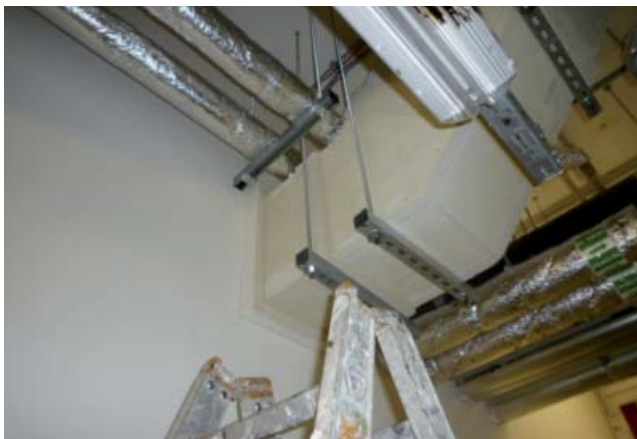
Abb. 11: Überbauung von klassifizierten Bauteilen durch Bauteile ohne Feuerwiderstand bei Nichteinhaltung der Mindestabstände aus den Verwendbarkeitsnachweisen der technischen Gebäudeausrüstung
