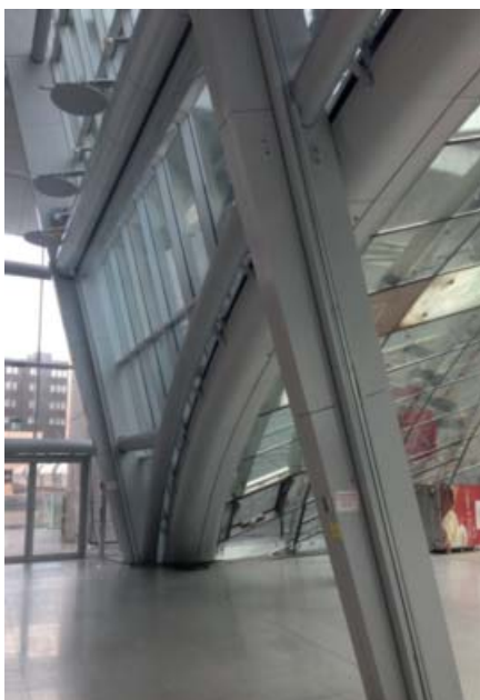
Abb. 14: Feuerschutzabschluss in der Qualität EI 90 zwischen dem ICE-Bahnhof und „The Sqaire“ am Frankfurter Flughafen
