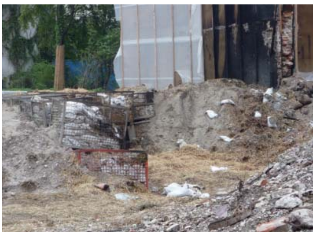
Abb. 7: Seitliche Verdämmung der Bombe mit Stahlkörben, gefüllt mit Sandsäcken; Situation nach der Sprengung
