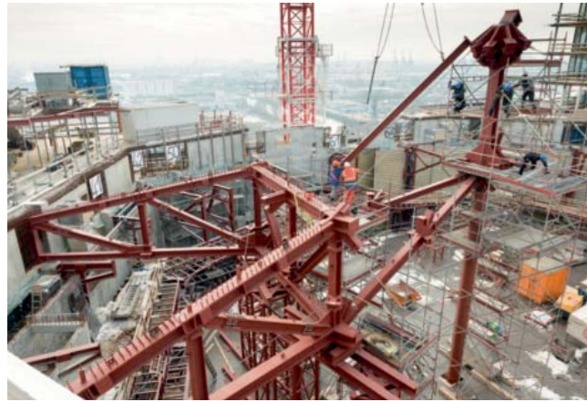
Abb. 7: Beginn der Stahlbaumontage am Sternknoten Ost. Kleinteilige Montage im Bereich des Huts. Im Hintergrund sind die Trapezbleche für die Innenschale zu sehen
