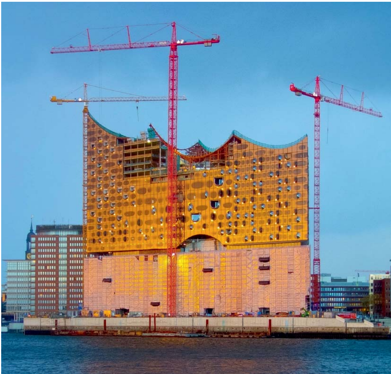
Abb. 2: Ansicht der Elbphilharmonie vom Anleger Arningstraße
