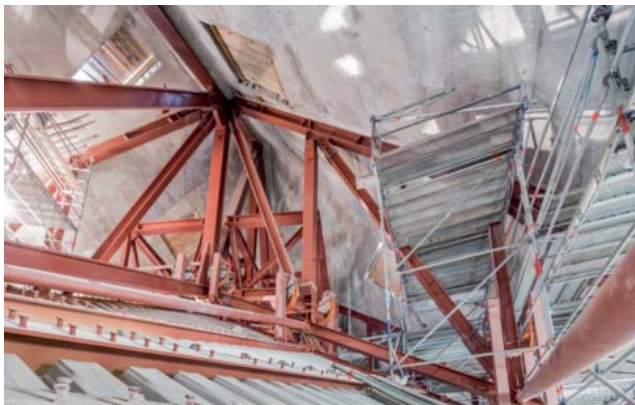
Abb. 13: Schalenzwischenraum mit Blick in Richtung Abluftbauwerk. Zu sehen ist der Kreuzungspunkt eines großen Fachwerks mit dem Firstfachwerk, ein Teil des Abluftbauwerks sowie die Träger und Trapezbleche der Innenschale vor dem Betonieren
