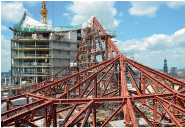
Abb. 6: Saaldachfachwerk während der Montage. Im Hintergrund der Gebäudebereich mit den Wohnungen und den bereits montierten Gebäudedachflächen 1 und 2
