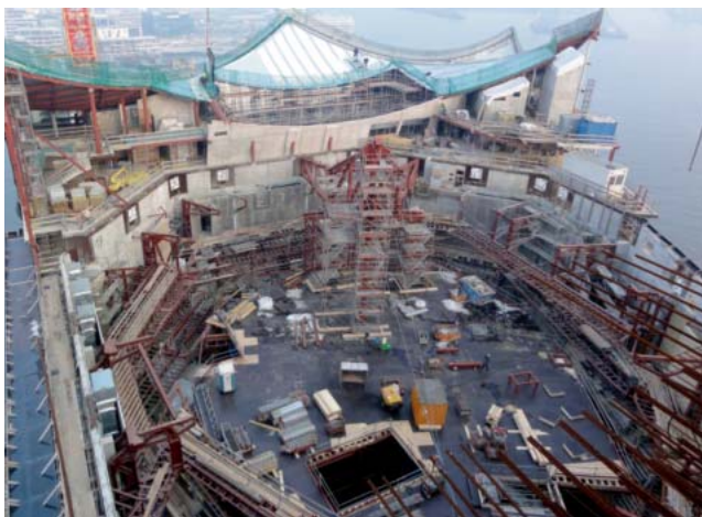
Abb. 3: Blick in den Konzertsaal zu Beginn der Saaldachmontage. Zu erkennen ist der obere Teil der Tribünen sowie der Montagetisch. Im Bereich der Rippen 31 bis 50 wurde die lotrechte Spritzbetonwand zwischen den Tribünen bereits hergestellt
