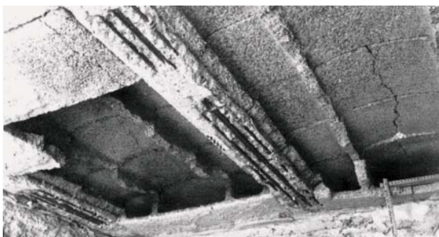
Abb. 14: Abplatzungen einer Balkendecke mit Zwischenbauteilen aus Beton nach DIN 4158 aus [5] mit freiliegender Bewehrung
