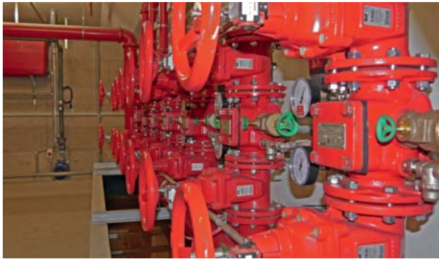
Abb. 5: Nassalarm-Ventilstationen einer Sprinkleranlage
