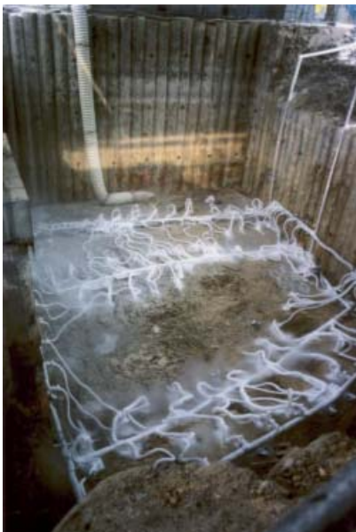
Abb. 11: Die Vereisung des Bodens kann auch als Schutz vor Kontaminationen dienen; so wurde hier in einer durch Bohrpfähle gestützten Baugrube zum Aushub von Teerrückständen an einem ehemaligen Gaswerkstandort der ins Grundwasser reichende Kontaminationsbereich gefroren und bis zum unbelasteten Bodenbereich ausgehoben.
