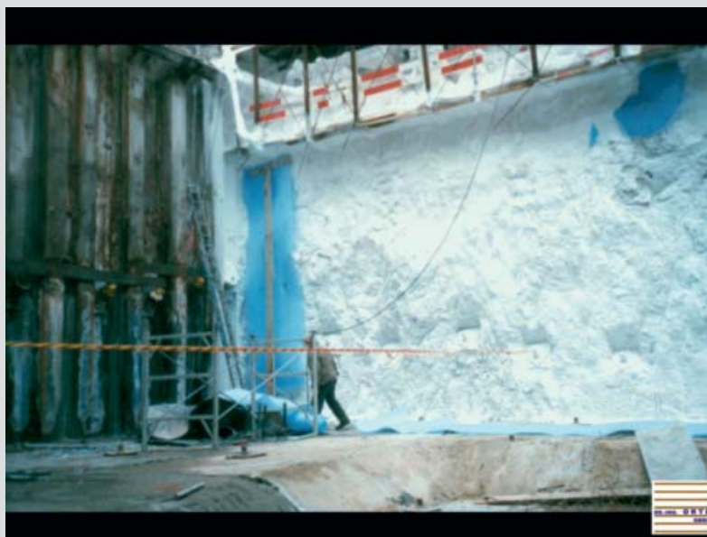
DIESE GEFRORENE BAUGRUBENWAND diente beim Bau des Rosmarin-Karrees in Berlin als abstützender und abdichtender Frostkörper und dokumentiert hier bildhaft und schlaglichtartig die großen Vorteile, die sich den Bauingenieuren mit dem Einsatz der Gefriertechnik bieten. Viele Beispiele für diese Vorteile sind zu finden ab Seite 27
