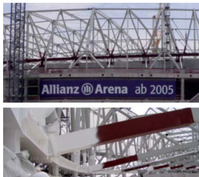
Abb. 3: Applikation eines RBS in einem Fußball-Stadion: Dachkonstruktion der Allianz Arena in München und mit einem reaktiven Brandschutzsystem beschichteter Knotenpunkt des Ringankers [3]
