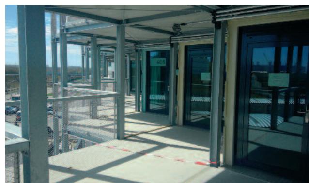
Abb. 6: Ungeschützte Stahlkonstruktion der Laubengänge mit Stahlbetondecken
