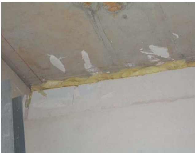
Abb. 9a: Unzureichender Deckenanschluss einer nichttragenden F90-Wand Figure 9a: Insufficient floor connection of a non-load bearing F90 wall
