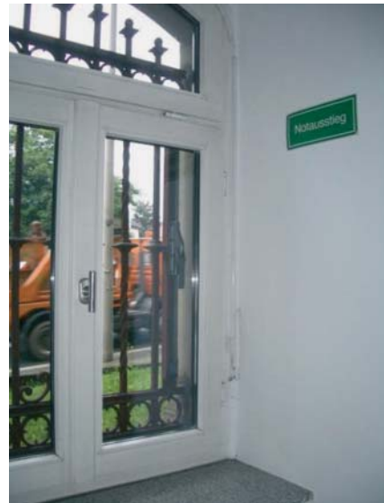
Abb. 5b: ... ein fest vergitterter Notausgang sind generell nicht akzeptabel.
