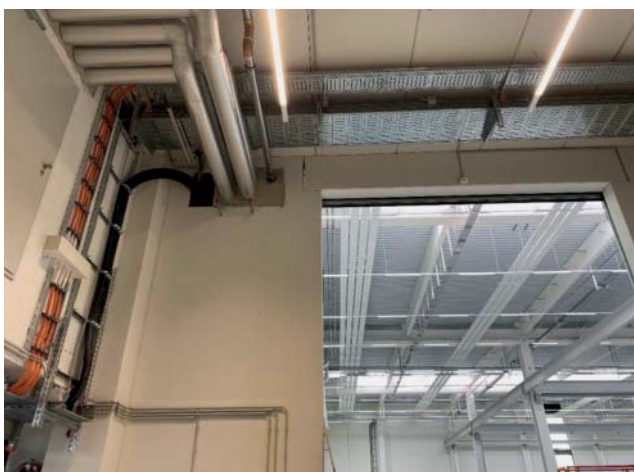
Abb. 12: Der durch die Brandwand blitzende Sonnenstrahl entlang der Fugen im Sturzbereich des E190 Tores verhinderte die mangelfreie Endabnahme.
