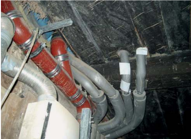
Abb. 13a: Solche mangelhafte Leitungsführungen oder -schottungen in Holzbalkendecken oder ...
