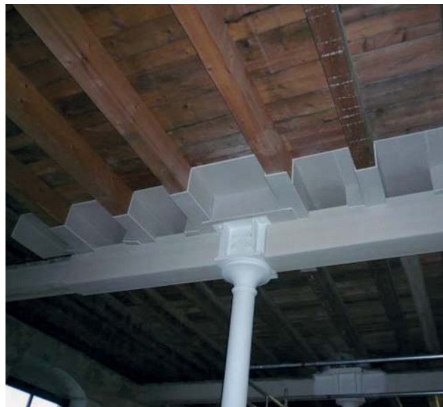
Abb. 10a: Feuerschutz für Holz, Stahl und Gusseisen durch Trockenbau und Dämmschichtbildner (DSB) Figure 10a: Fire protection for wood, steel, and cast iron by dry walling and intumescent (ge: Dämmschichtbildner, DSB)
