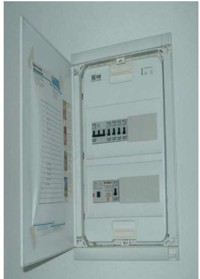
Abb. 11b: ... die ein erhebliches Brand-, Schall- und Wärmeschutzproblem darstellen.
